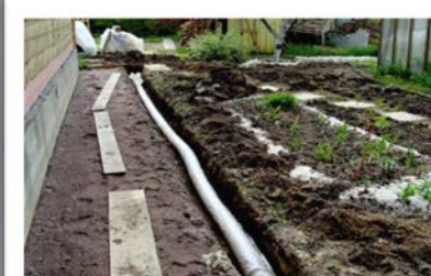
ดูแลระบบระบายน้ำให้พร้อมใช้
